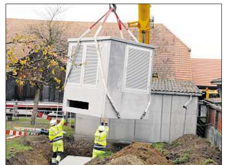
Die Häuser der neuen Überbauung Aspi in Moosseedorf benötigen Strom. Damit die Kapazität auch bei Spannungsspitzen gewährleistet ist, wurde auf der Schössliwegmatte eine Trafostation installiert. sin.
